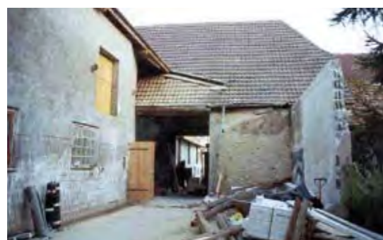
Beim Umbau einer Scheune in Kolitzheim konnte die alte Baustruktur im Ortskern weitgehend erhalten bleiben.
